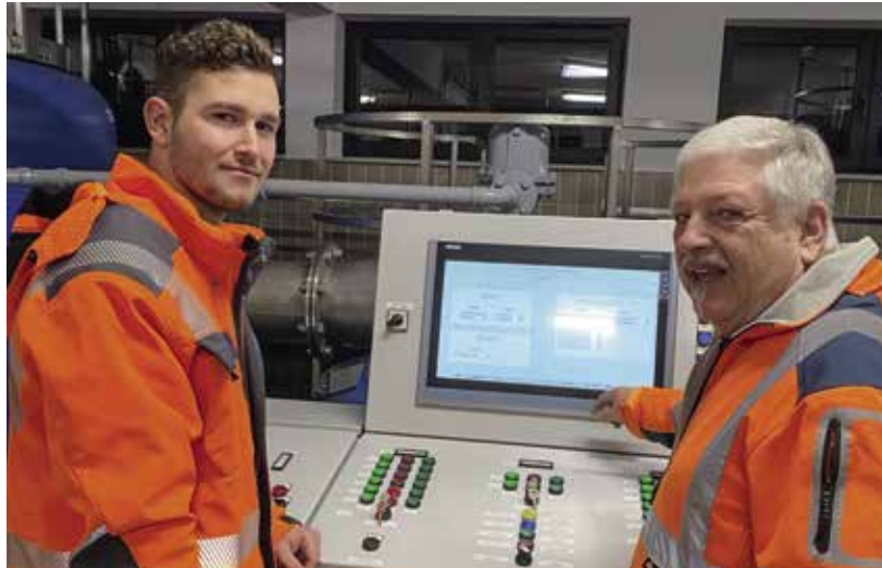
Julian Fitz und Wassermeister Andreas Fellermeier im Maschinenraum des Brunnen 6
