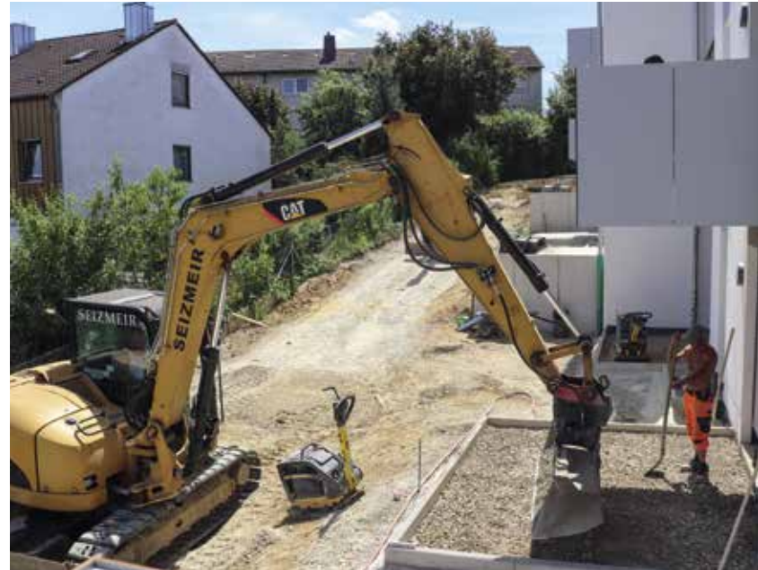
Derzeit stehen in der Stettbergstraße 24 Wohneinheiten für Singles, Paare oder Familien kurz vor der Fertigstellung.
