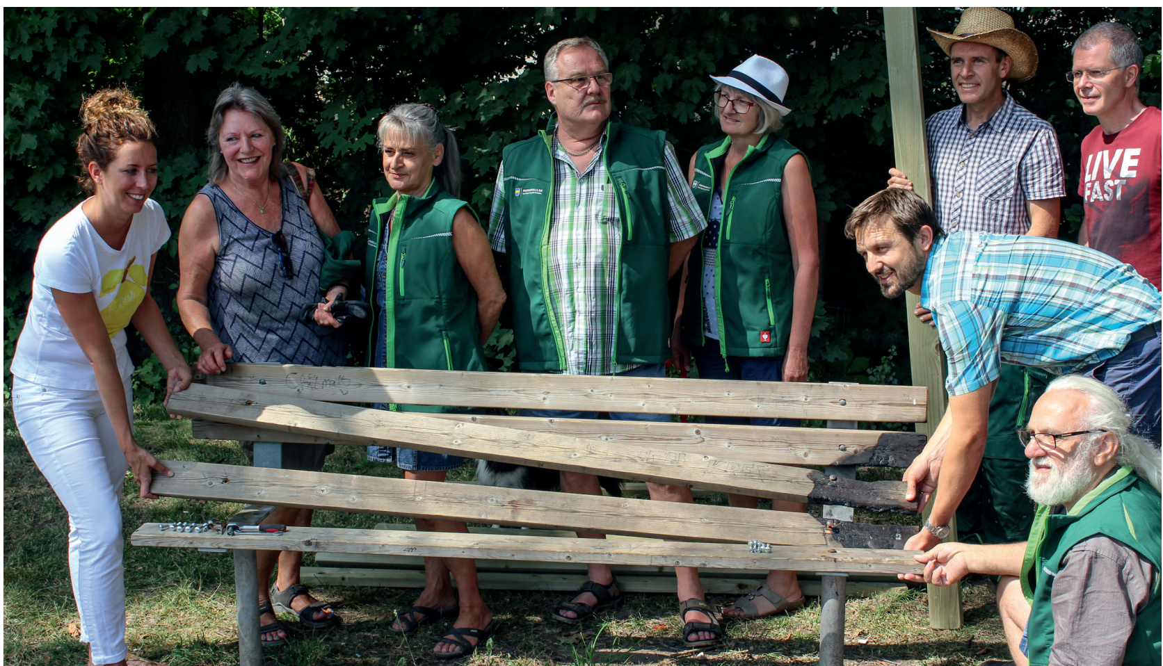
Die Gerolsbach-Paten mit Vertretern des Stadtrats und des Bauamts beim Reparieren einer zerstörten Sitzbank (Foto aus dem Jahr 2018).
