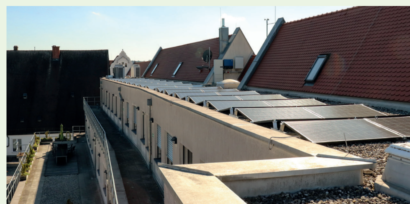
Photovoltaikanlage auf dem städtischen Verwaltungsgebäude
