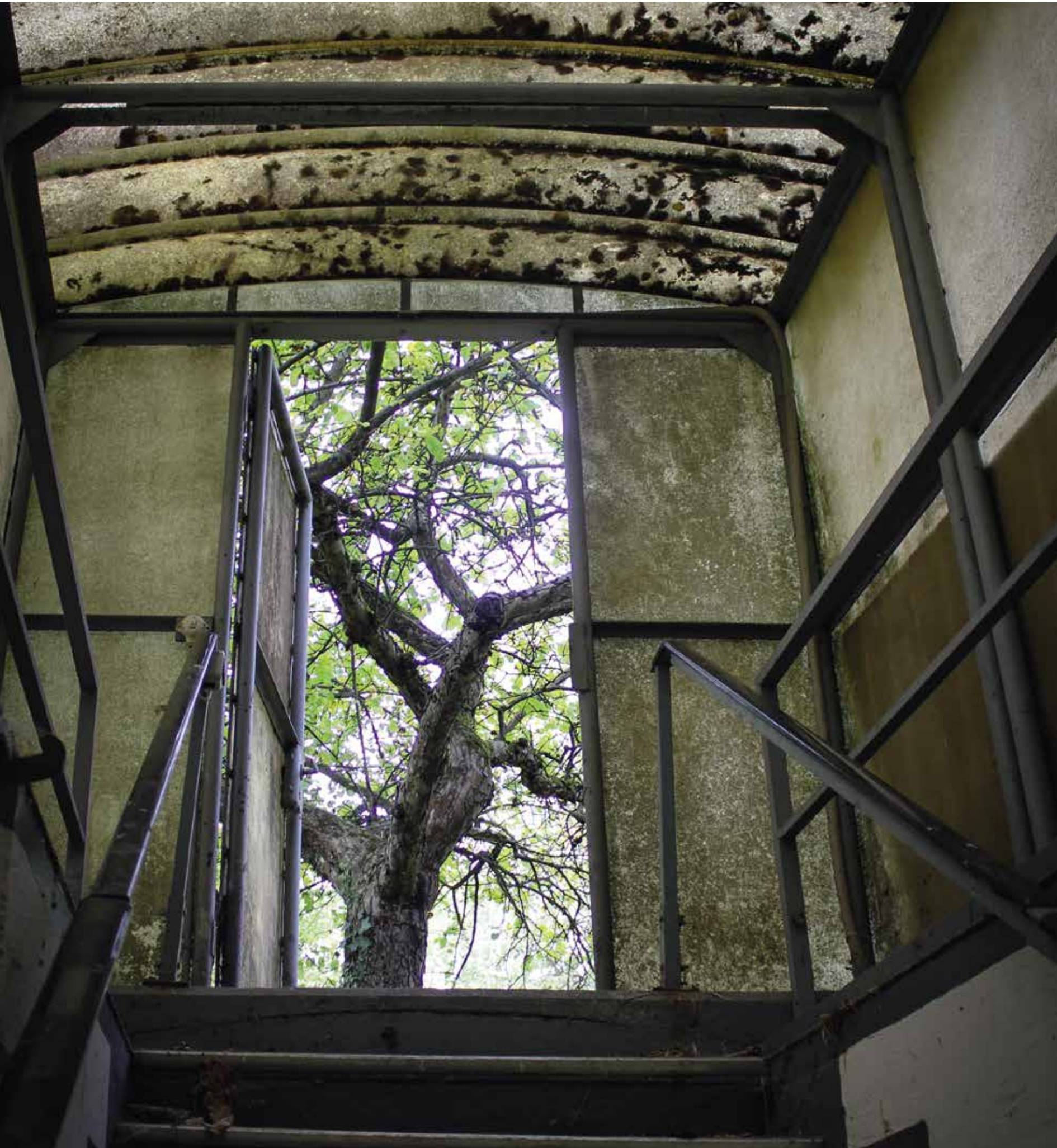
Der Bunker, der lange unter strengster Geheimhaltung stand und der Kenntnis der Zivilbevölkerung verborgen blieb, wurde erst 2014 der Öffentlichkeit zugänglich gemacht.
