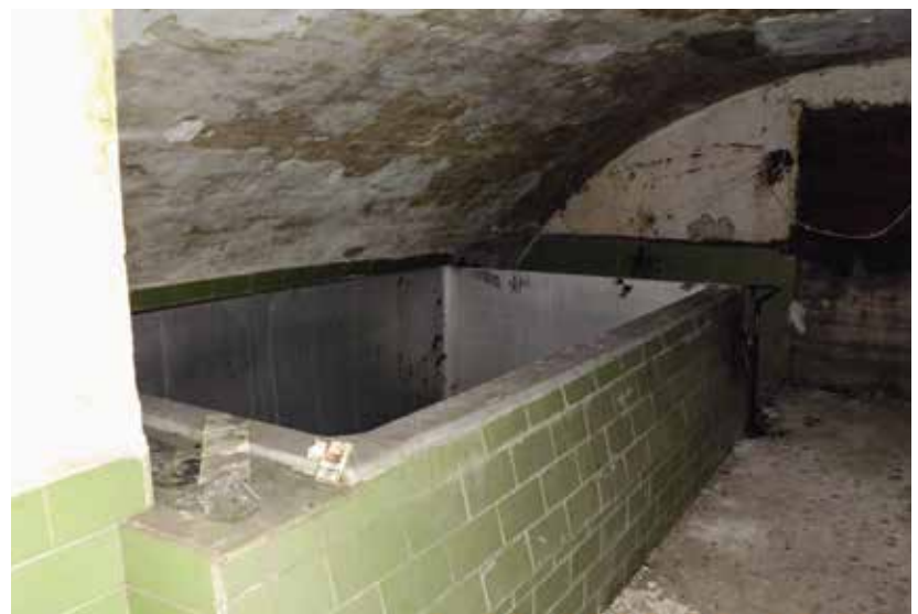
Im früheren Amberger-Bierkeller sind auch noch die alten, offenen Gärbecken erhalten.
