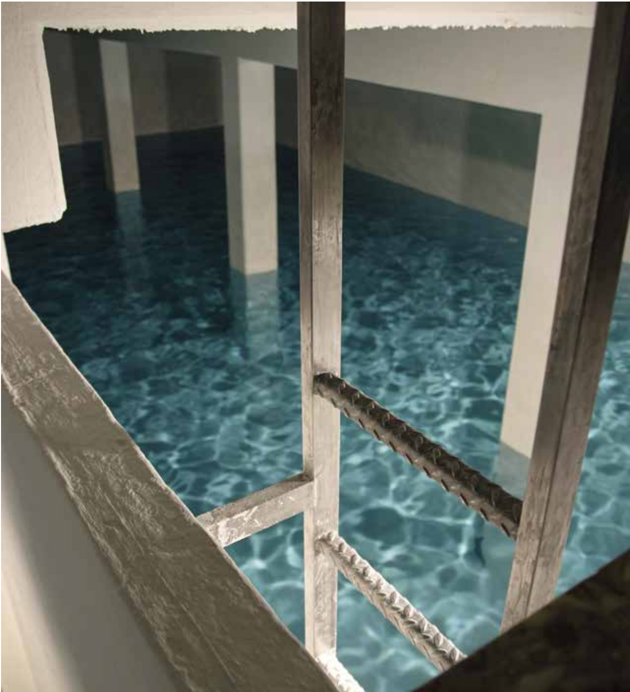
Glasklares Wasser – so sieht das Wasserreservoir des Stadtwerke Wasserwerks über Pfaffenhofen aus. Hochbehälter werden in der Regel höher als der höchste zu versorgende Wasserhahn gesetzt, damit das Wasser durch den natürlichen Druck bis zu seinem Bestimmungsort fließen kann.
